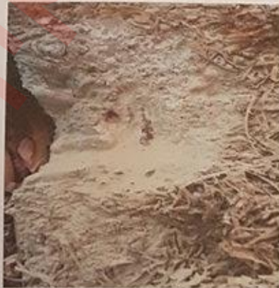
Fig.5 Degradimi i betonit të kolonës
